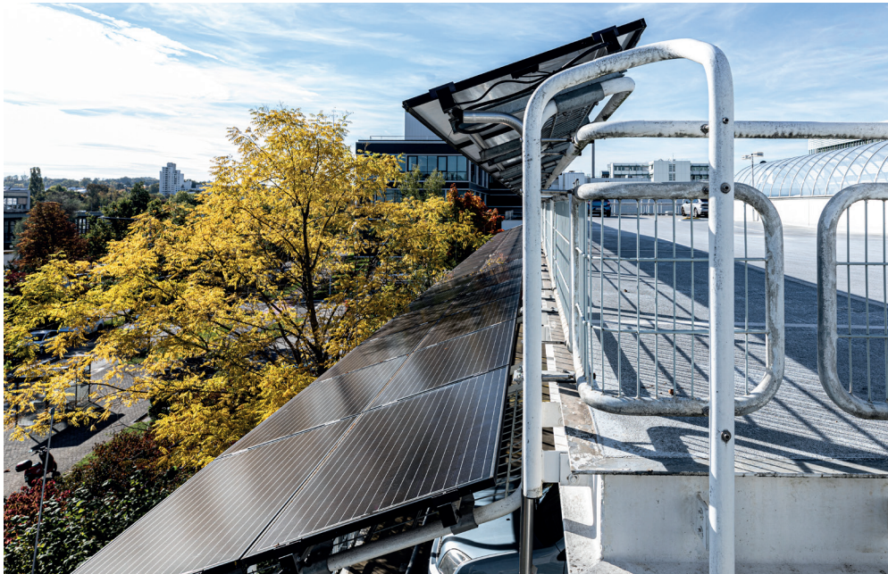
Solarpaneele am Parkhaus des Fraunhofer-Institutszentrums in Stuttgart.
